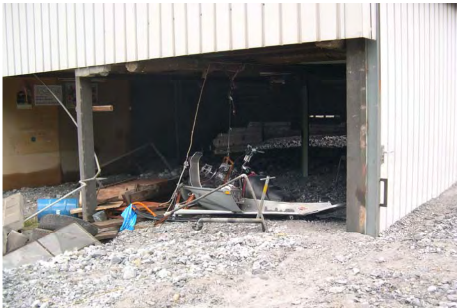
Danni sedime magazzino Mondaccia
