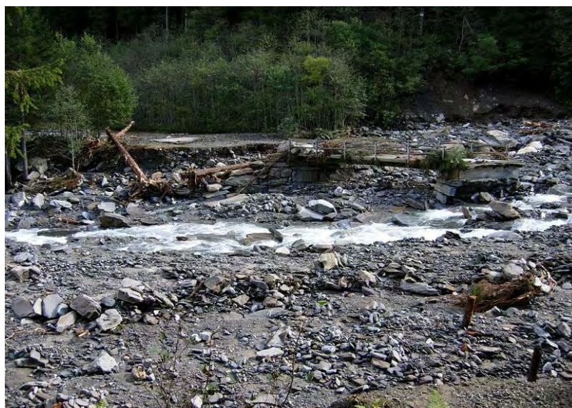
Ponte alluvionato con erosione degli accessi
