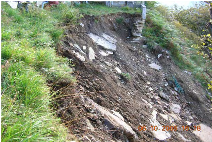
Zona di stacco frana Fracion
