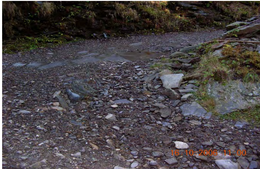
2° tornante – danni alla sovrastruttura
