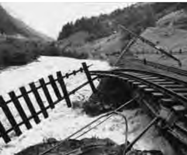
Hochwasser 1987: Seitenerosion in Gurtellen UR (Comet)
